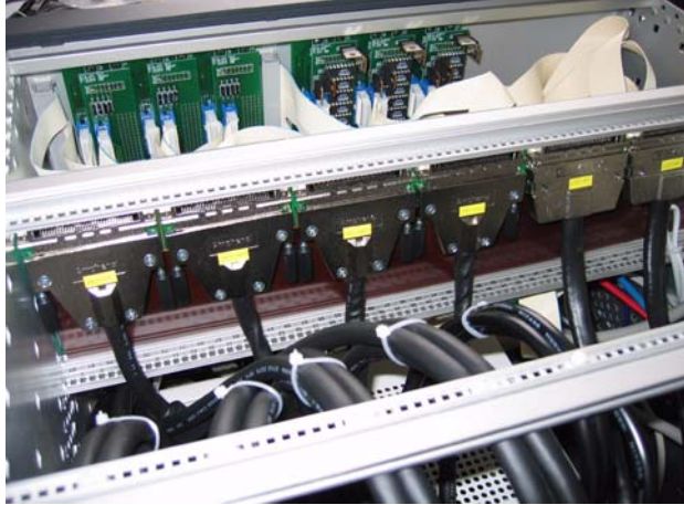
Bild 4: Signalverteilung und -anpassung innerhalb des 19"-Racks
